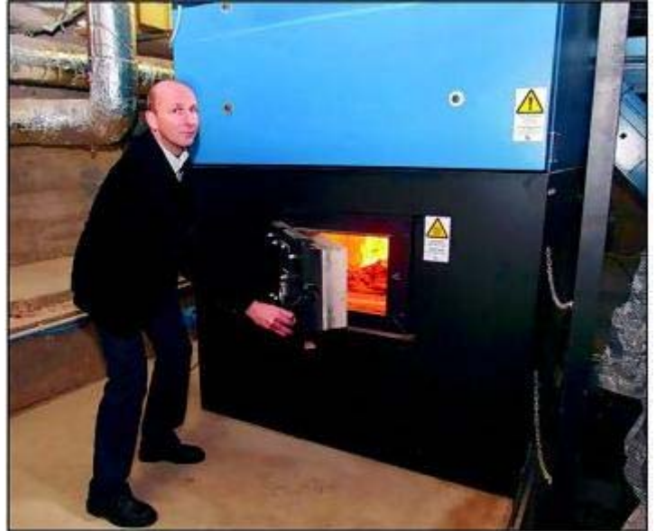
Axel Kasprzyk vom Energiemanagement der Stadt zeigt die Befuerung der neuen Hackschnitzelanlage. FOTO: THÜRING
